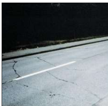
Figura 3: Esempio di fessurazione trasversale
