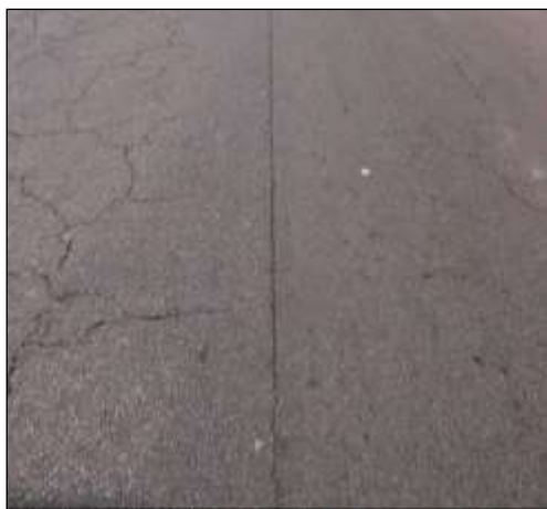
Figura 11: Fessura longitudinale da giunto di stesa.
