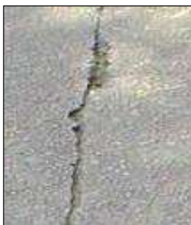
Figura 2: Esempio di fessurazione longitudinale
