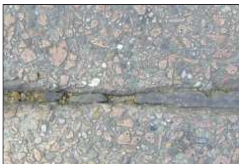
Figura 5: Degrado dei giunti precedentemente sigillati
