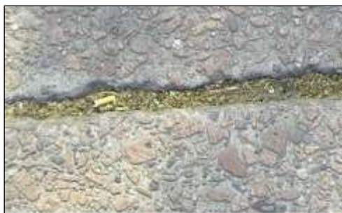
Figura 4: Degrado dei giunti non sigillati
