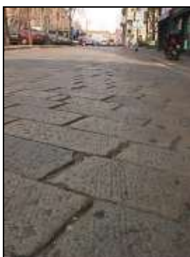
Figura 12: Eccessiva apertura dei giunti non sigillati
